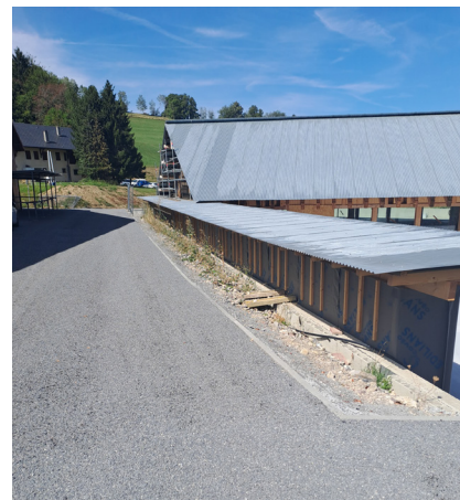
Revêtement d'un bi-couche entre le groupe scolaire et la salle des fêtes
